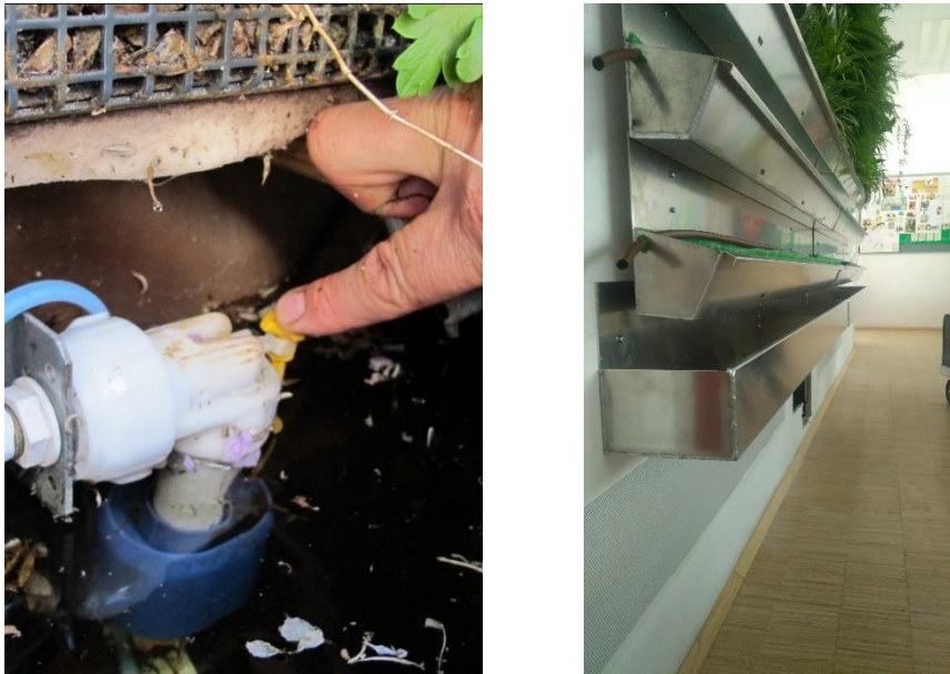
Abbildung 22: Pumpe im Wassertank beim Kassettensystem außen (links); Wassertank unter dem Trogsystem innen (rechts)
