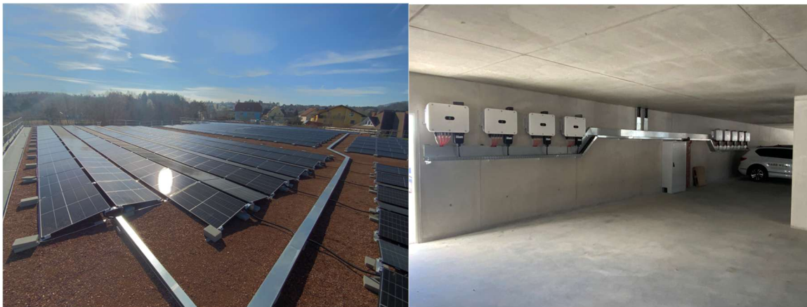
Abbildung 4: Details PV-Anlage (Module und Wechselrichter)
