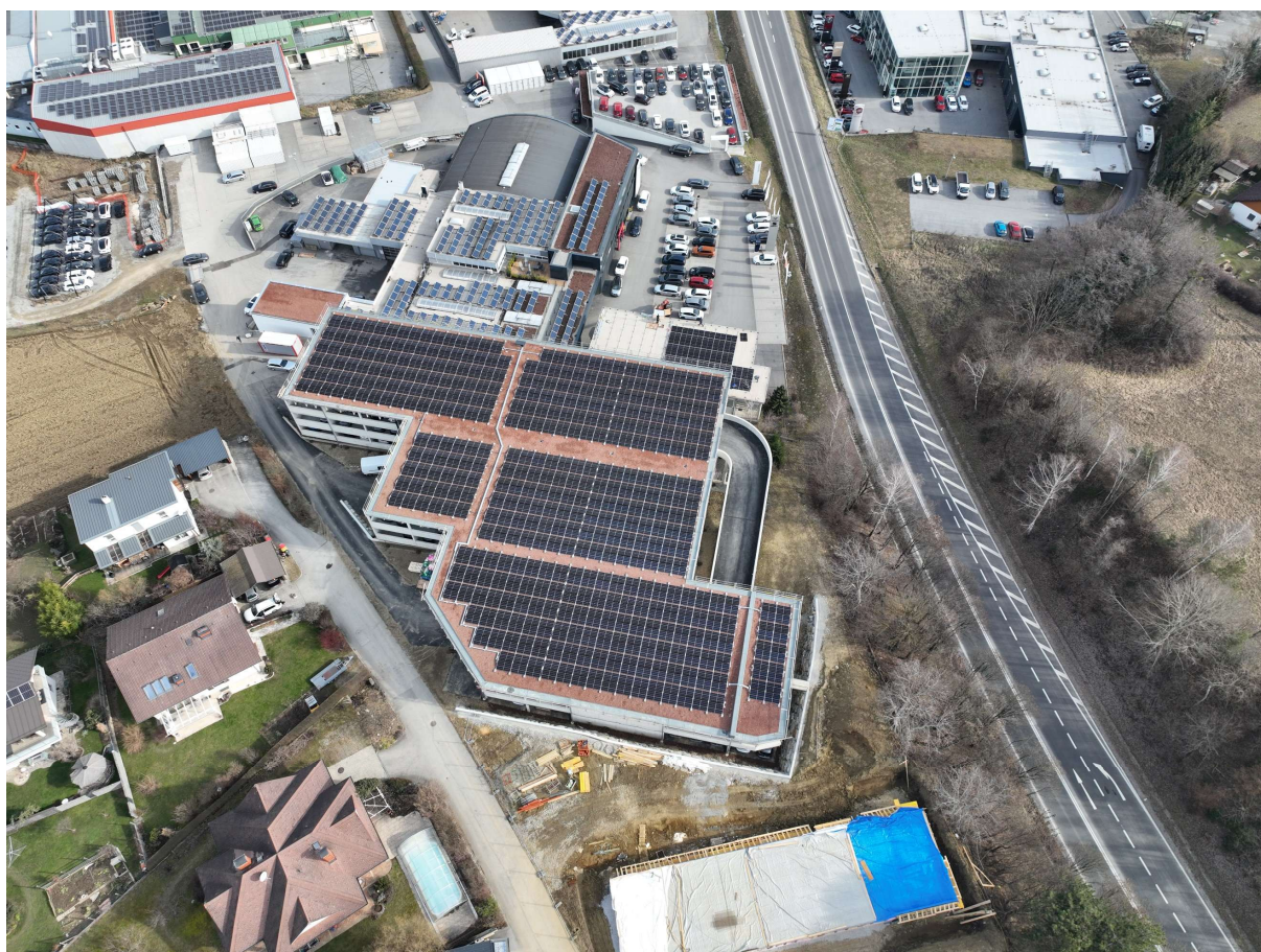
Abbildung 3: PV-Anlage Gesamtsicht auf Firmengelände
