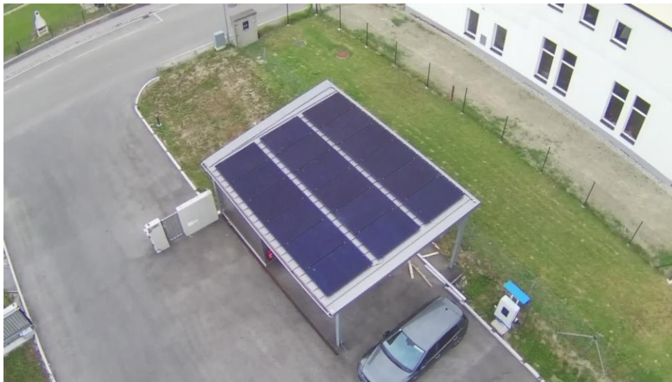
USV + Energiespeicher Schuppen – 18 Module -440Wp
