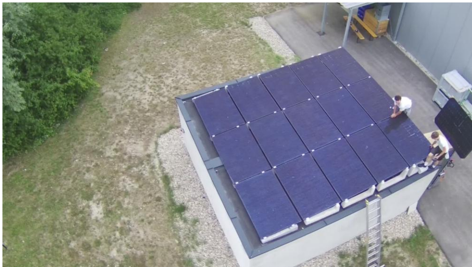
Garage – Segeldach – 15 Module – 440 Wp
