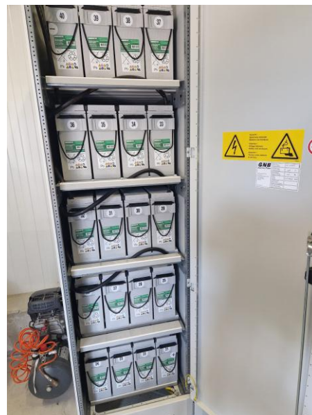
Batterieanlage 40 x M12F190PC
