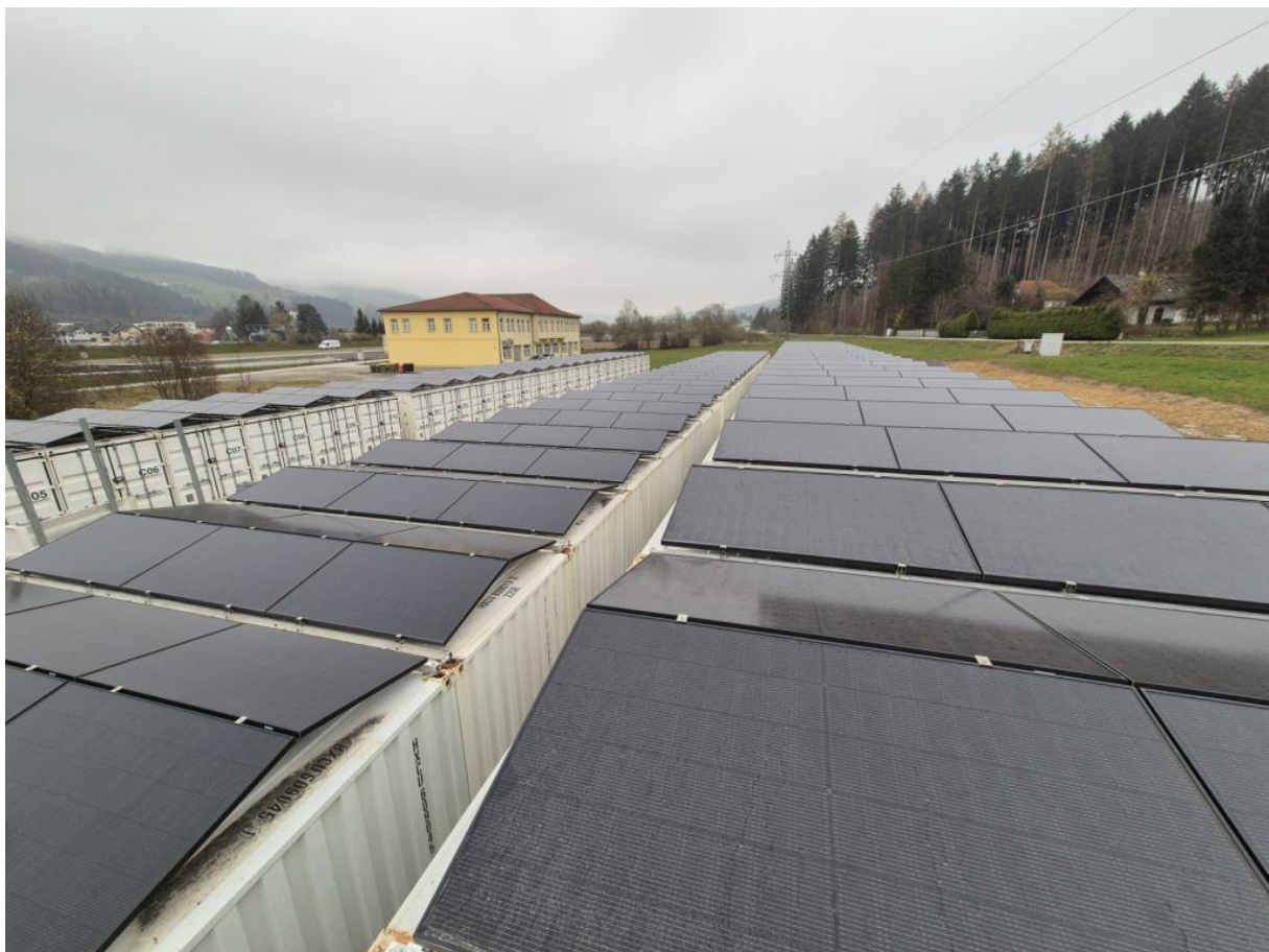
Ansicht der bisher installierten Moduldächer
