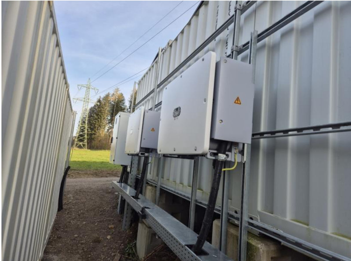
Bild – Wechselrichteraufhängung und AC Anschlüsse
