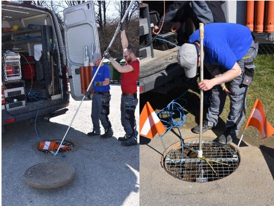
Abb.3-4: Prinzipielle Darstellung Positionierung Mess-Sonde über Teleskopstangen, mobile Messungen mit Mess-Sonden, Analyse-Station im Messbus und entsprechendem Sicherheitsgitter für offenen Schacht
