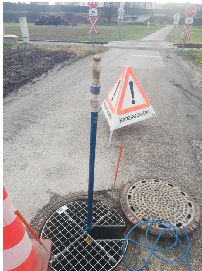
Abb.14: Messung bei Messpunkt 5 zum Erfassen der Abwassermengen der Zone RUFLING-BERG
