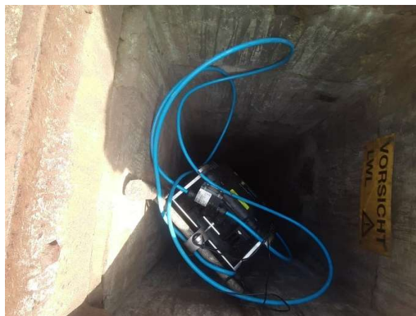
Abbildung 11: Messumformer für Durchfluss- und Temperaturmessung aufgehängt an Steigbügeln im oberen Schachtbereich
