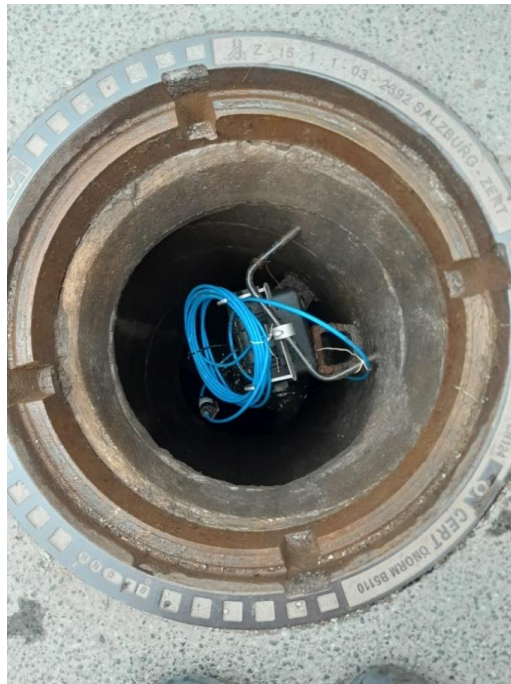
Abb. 8: Messumformer im Schacht mit Antenne zur Datenübertragung (MP 1)
