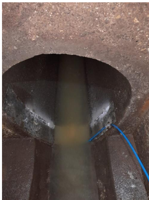
Abb. 9: Eingebautes Montageblech mit Keilsensor, welches an der Sohle des Kanals aufliegt und im Profil verspreizt wird (MP2-Hanuschplatz)
