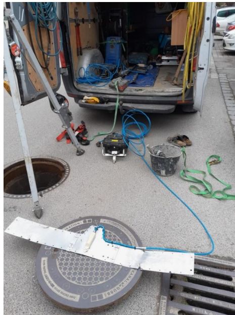
Abb.6: Keilsensor zur Erfassung von Temperatur, Füllstand und Geschwindigkeit, welcher mit dem Montageblech an der Sohle des Kanals aufliegt, Einbau MP 1
