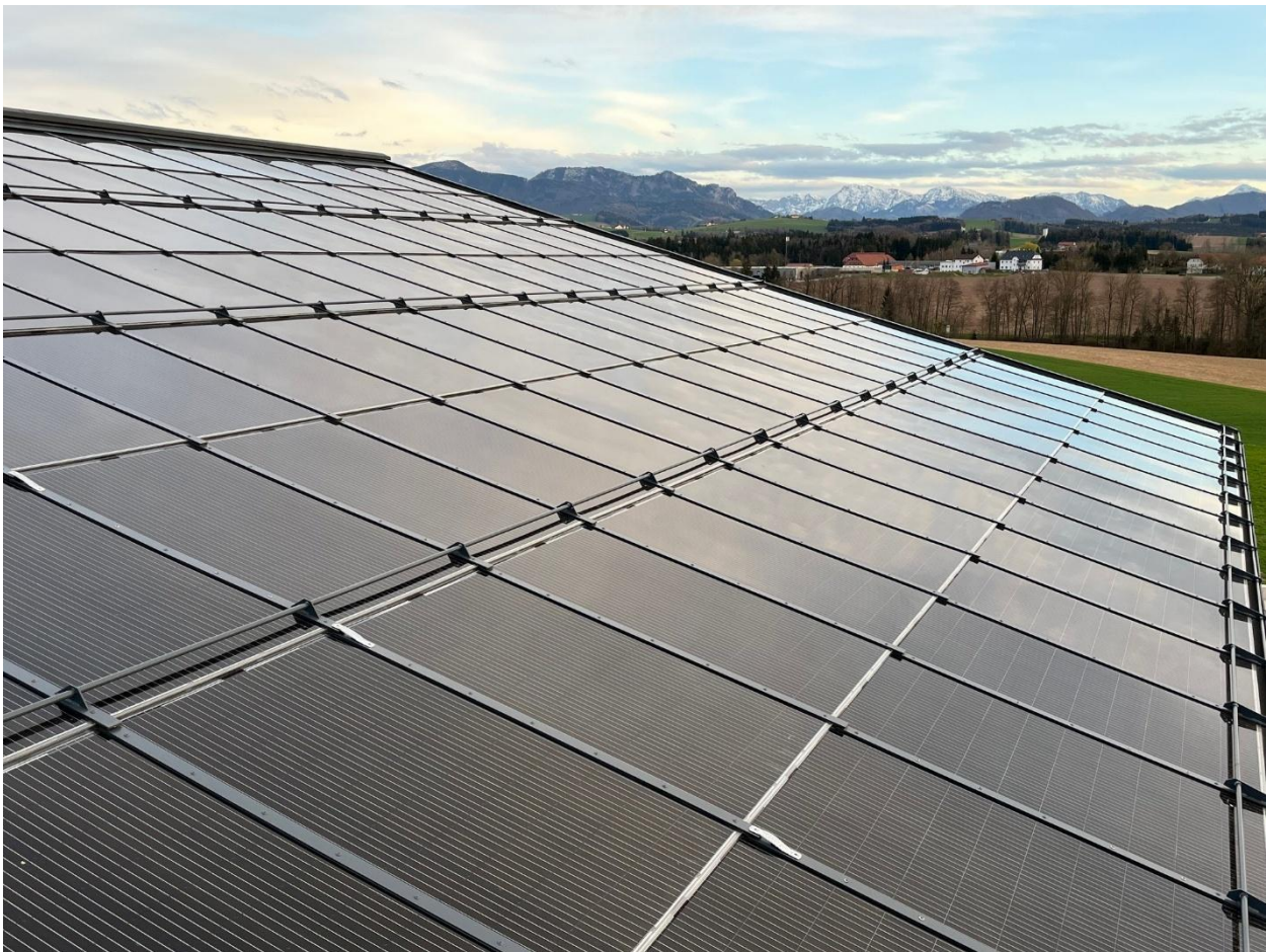
Indach-PV Projekt Göschl
