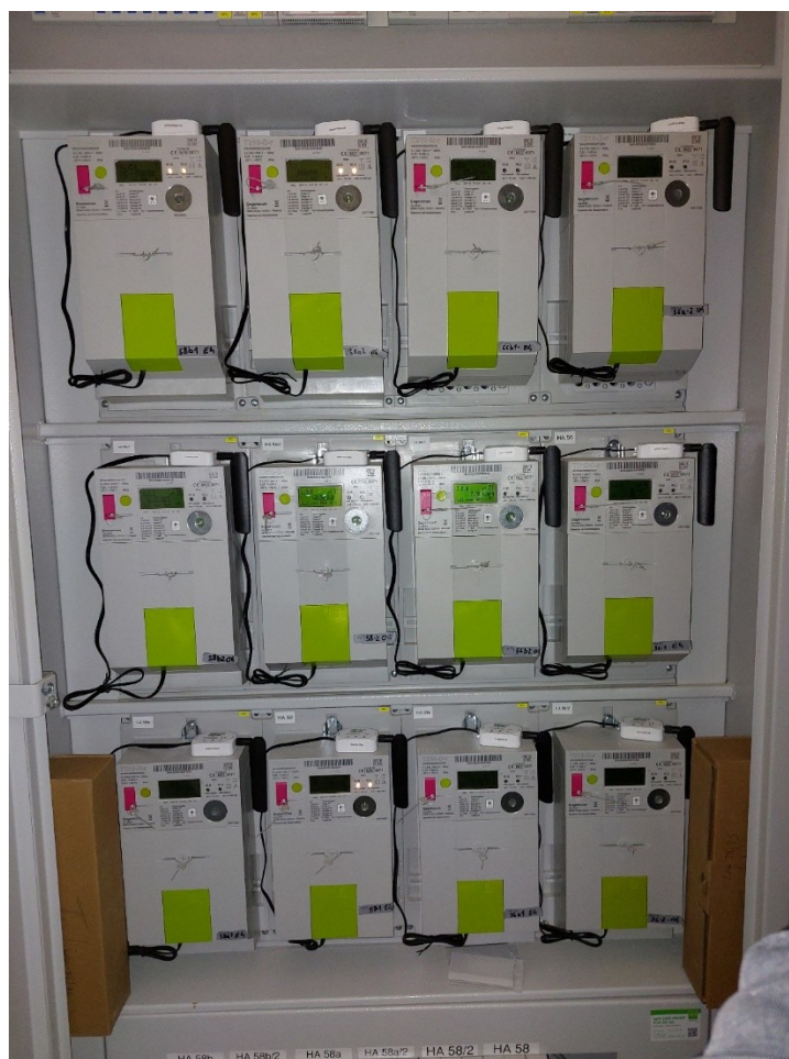
Abbildung 24: Smart Meter Reader im Einsatz (Quelle: energiedigital)
