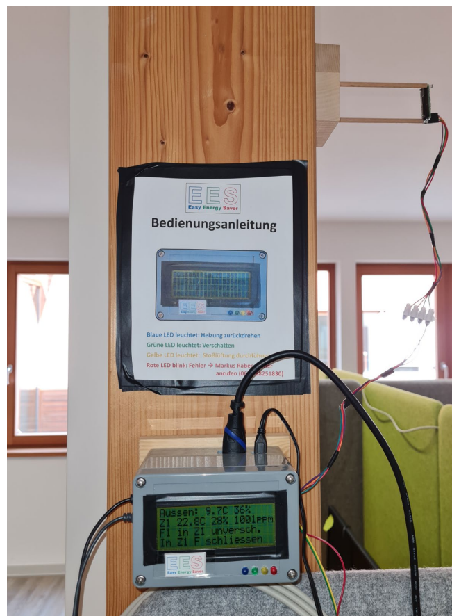
Abb. 26: Installierter Easy Energy Saver im Großraumbüro der 4ward Energy Research GmbH
