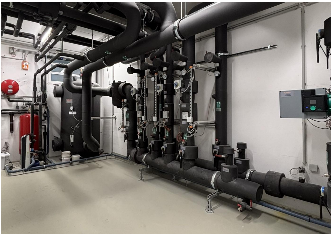
Abb.5: Technikzentrale im UG
