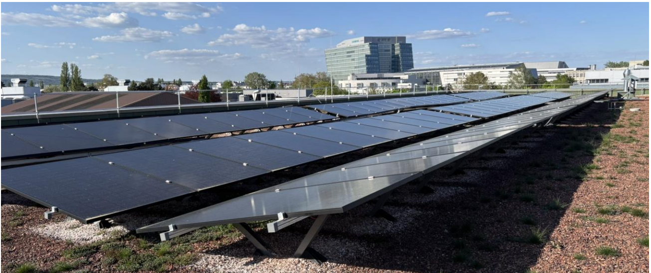
Abb.3: Dachbegrünung und PV- Elemente © Siemens AG
