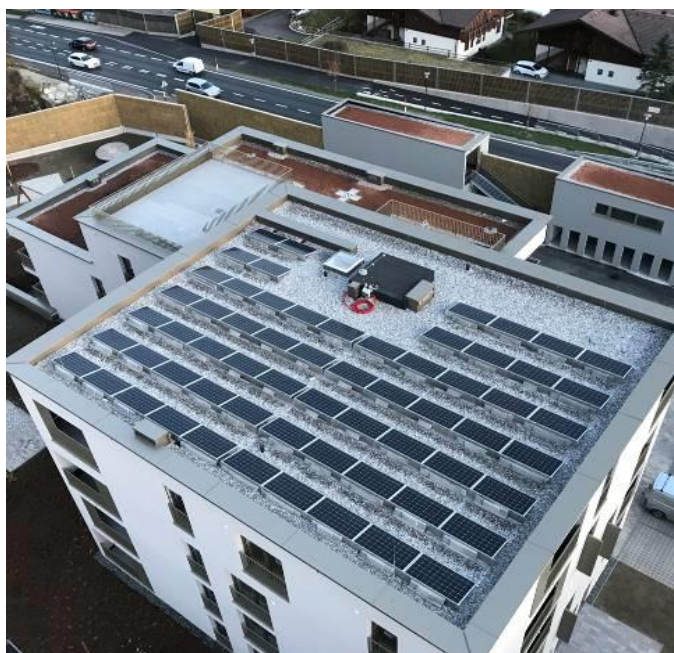
Abbildung 34: Impressionen der Photovoltaik-Anlage I (Salzburg AG, 2019)
