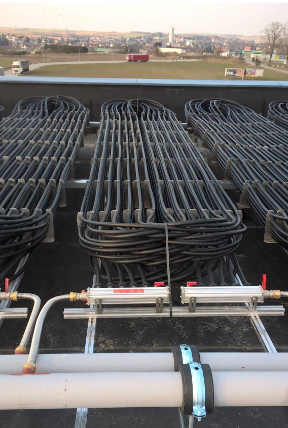
Am Flachdach fertig montierte und betriebsbereite Solarluftkollektoren SLK 600.
