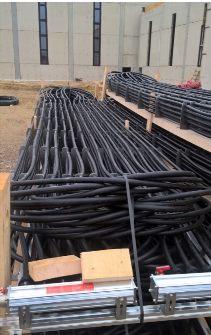
Lagerung der Solarluftkollektoren SLK 600 (rd. 298 m 2 ) vor dem Betriebsgebäude (Stahlbeton-Bauweise mit hinterlüfteter Fassade)
