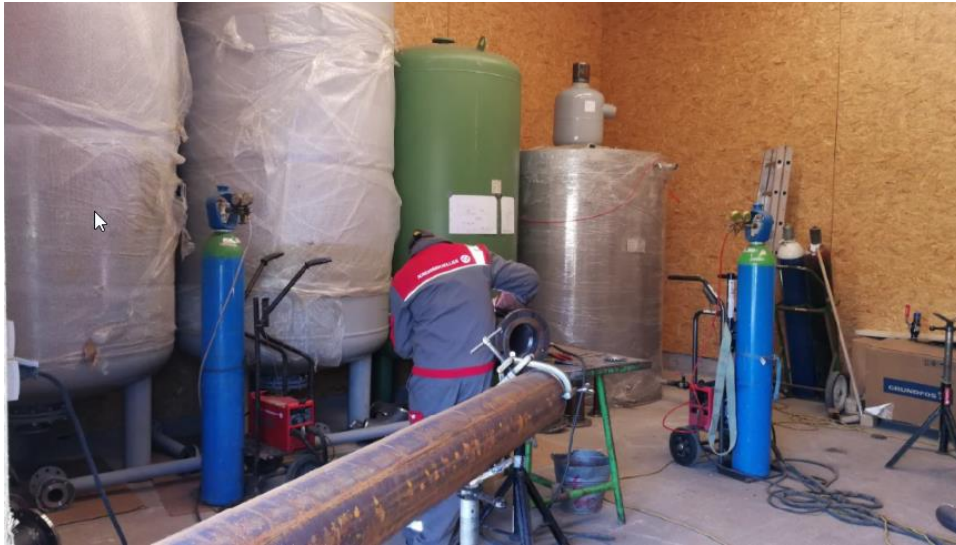
Abbildung 6: Der Innenausbau der Technikzentrale erfolgte parallel zur Errichtung des Solarfeldes. Im Bild sind die Ausdehnungsgefäße, Zwischengefäß und Auffangbehälter zu sehen.
