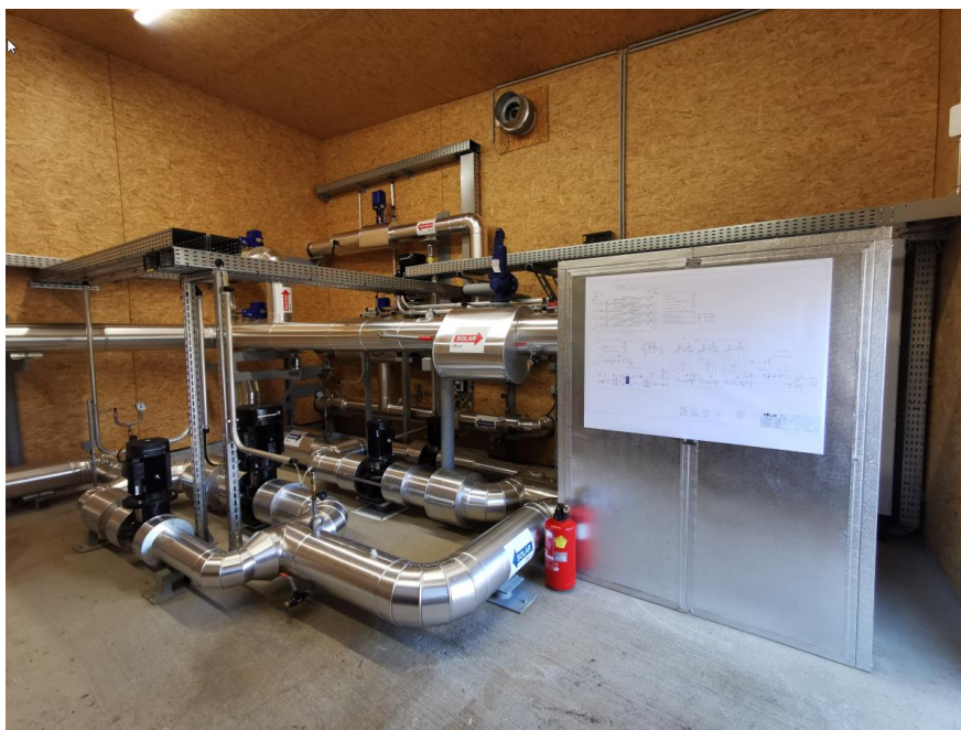
Abbildung 7: Die fertiggestellten Pumpengruppen für Solarkreis, Pufferkreis und Fernwärmeeinspeisung, sowie der Wärmetauscher als Systemtrennung
