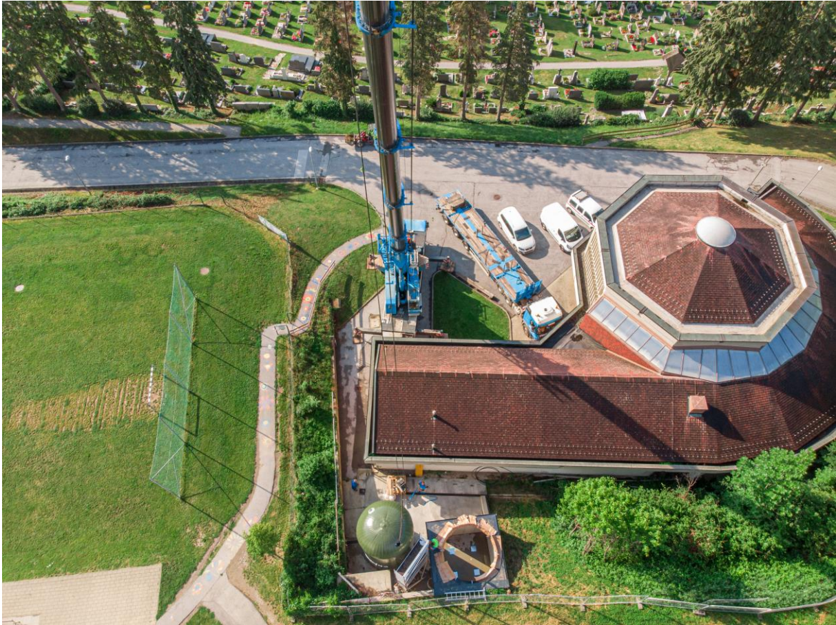
Abbildung 11 eingebauter Speicher (Quelle: W.E.I.Z.)
