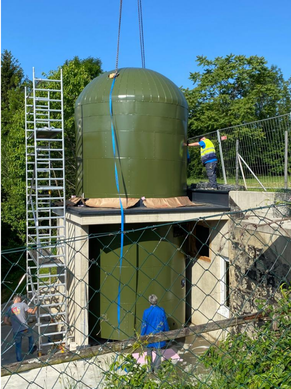
Abbildung 14 Speicher Quelle (W.E.I.Z.)
