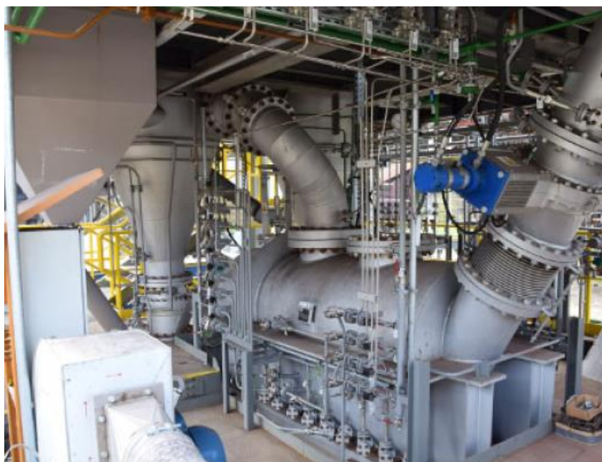
Abbildung 7 – Detailansicht der Anlage
