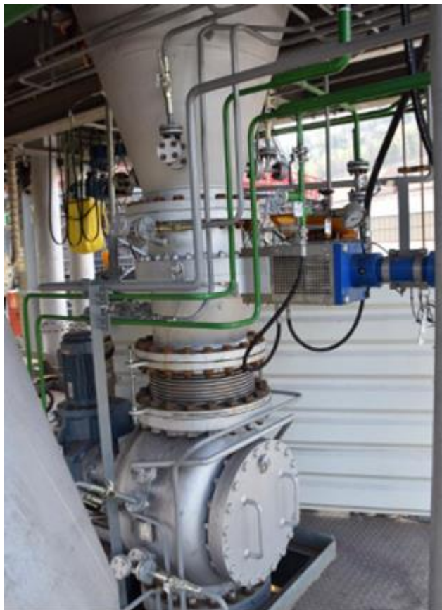
Abbildung 6 – Detailansicht der Anlage
