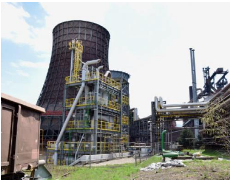
Abbildung 3 - Gesamtansicht der Anlage – Bild 1
