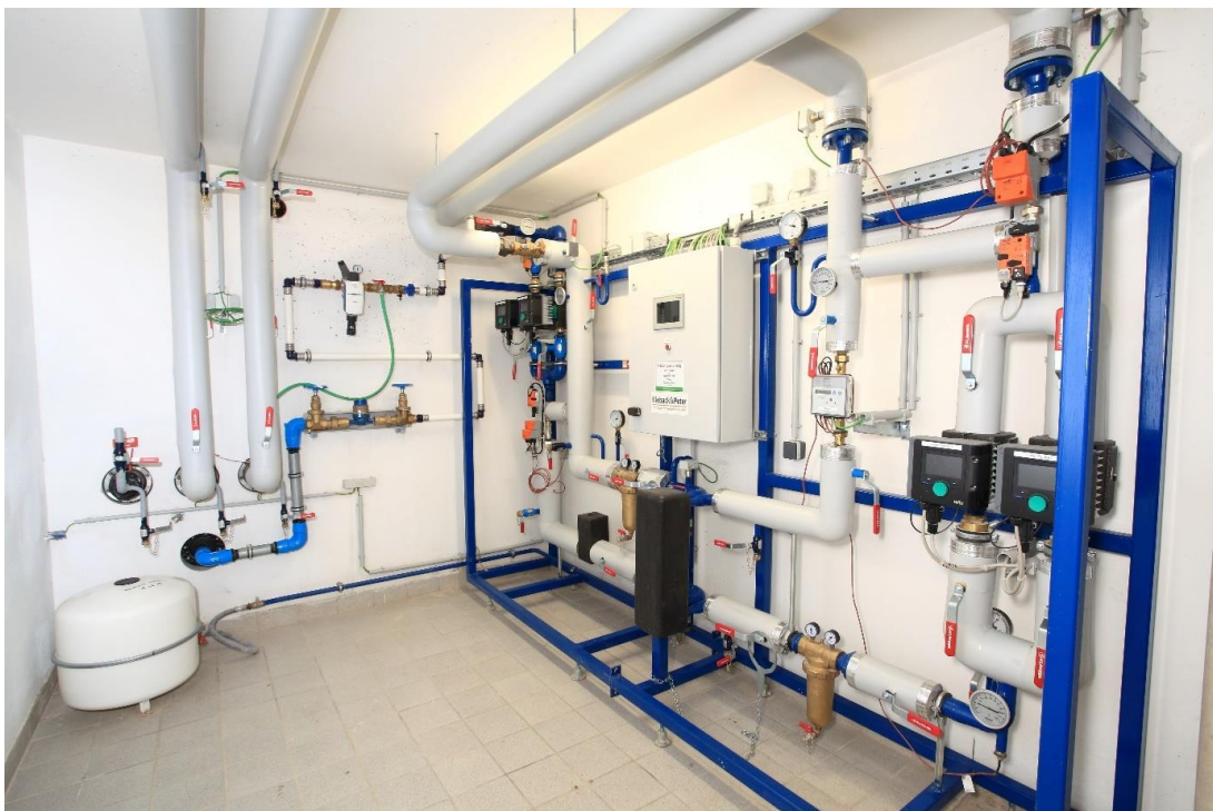
Abbildung 8: Übergabestation der kaskadischen Wärmenutzung
