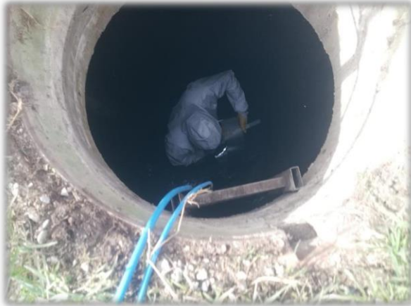
Abbildung 8: Einbau der Messeinrichtung in Messpunkt 2
