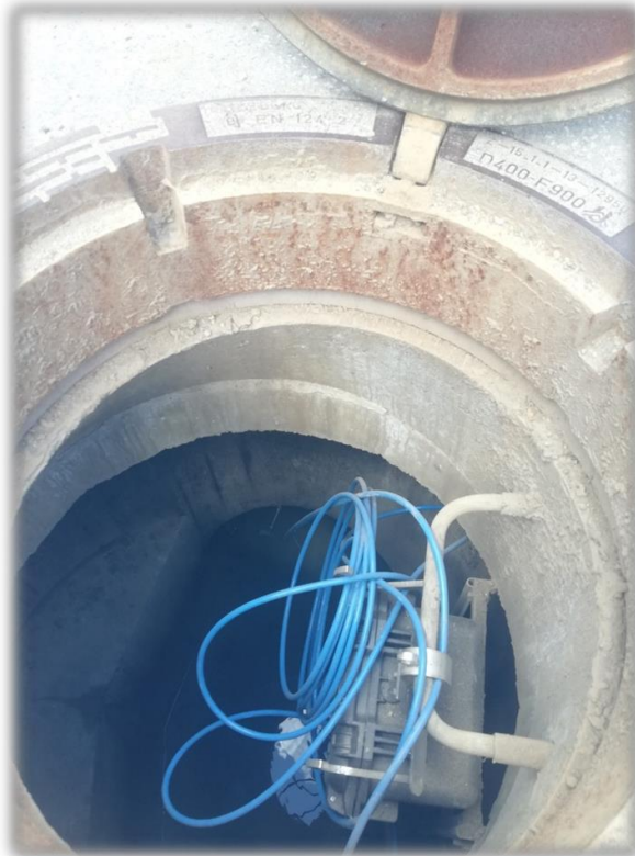
Abbildung 9: Fix eingebaute Messeinrichtung in Messpunkt 1
