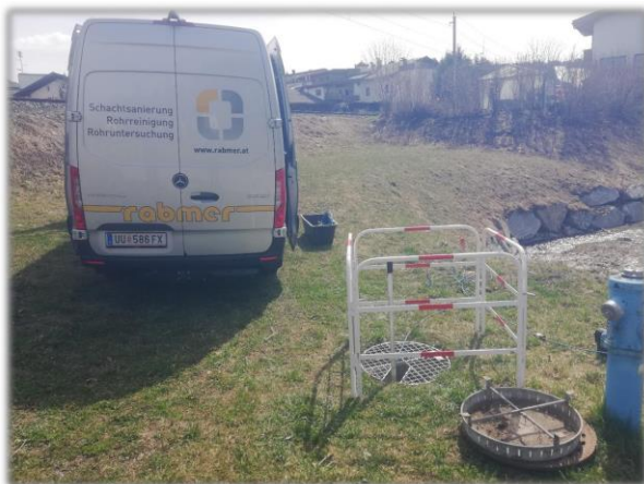
Abbildung 7: Messbus Fa.Rabmer mit mobiler Messung, Auswertung über Fernübertragung im Messbus, doppelt abgesicherter Schacht
