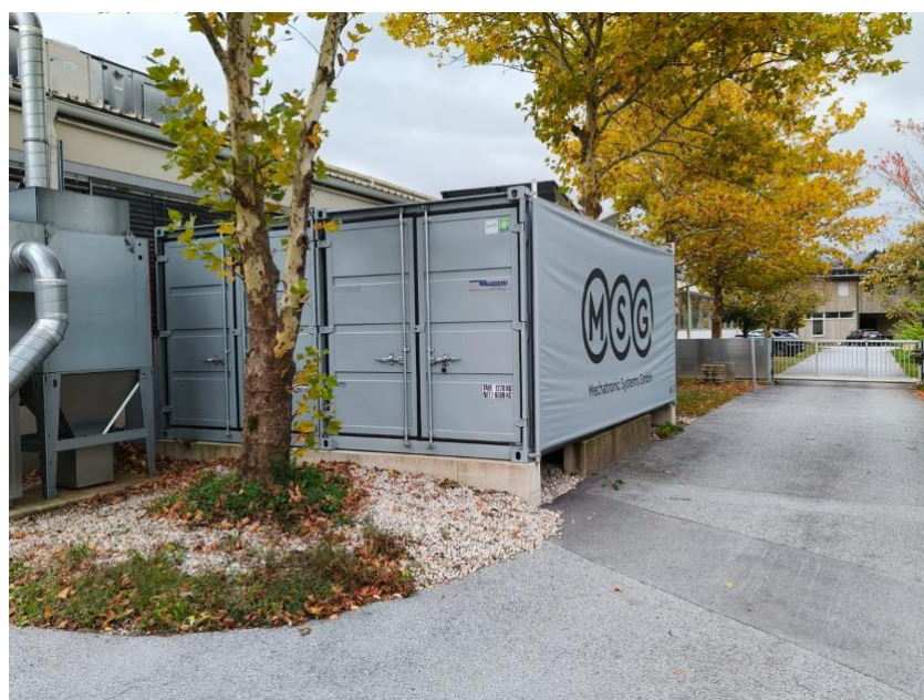
Abbildung 8: Container mit 20.000 Liter Pufferspeichern zum Speichern der Wärme / Kälte
