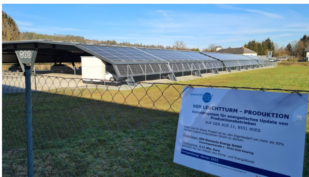
Abbildung 2: Bild der überdachten Stellplätze inkl. Photovoltaikanlage
