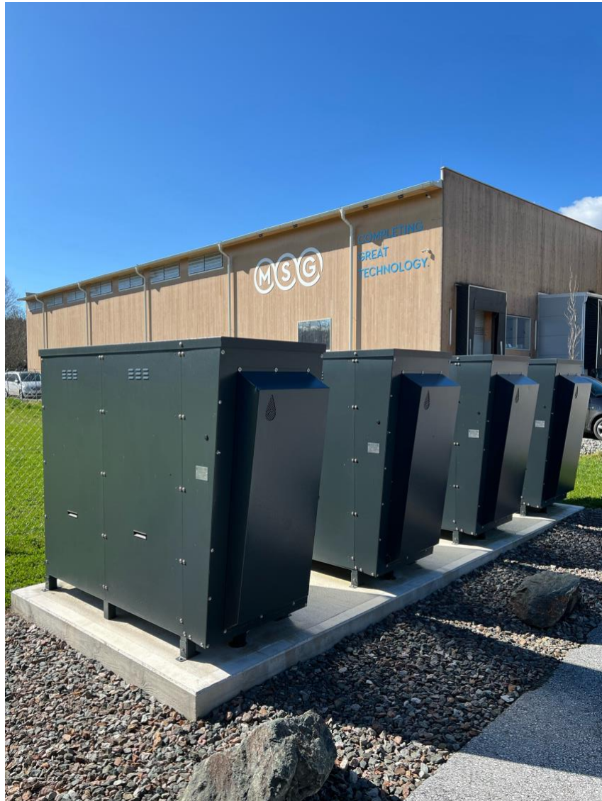
Abbildung 5: Energiespeicher JOH X1 der Firma EEG Elements Energy GmbH
