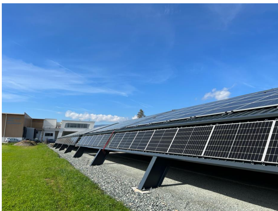
Abbildung 1: 600 kWp PV-Anlage auf den überdachten Stellplätzen
