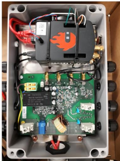
Abbildung 7: Finales AMB System mit zwei Red Pitaya Messboards und Signalkonditionierungsplatine.
