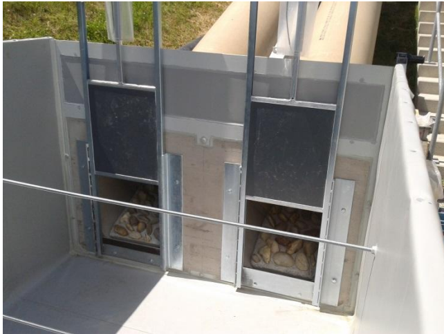
Abbildung 7: Verschlussorgane im Unterwasser
