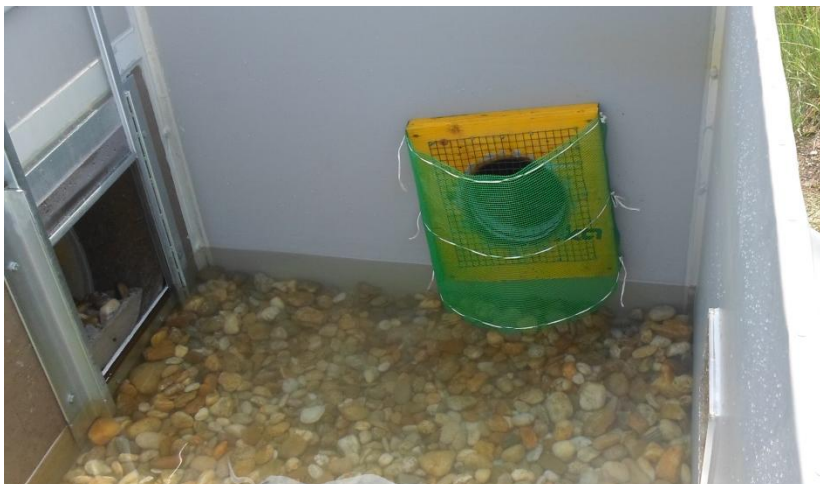
Abbildung 51: Netz bei Einlaufbecken-Zulauf
