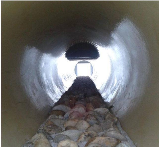
Abbildung 6: Kammer, Sohle und eingebauter Feinrechen
