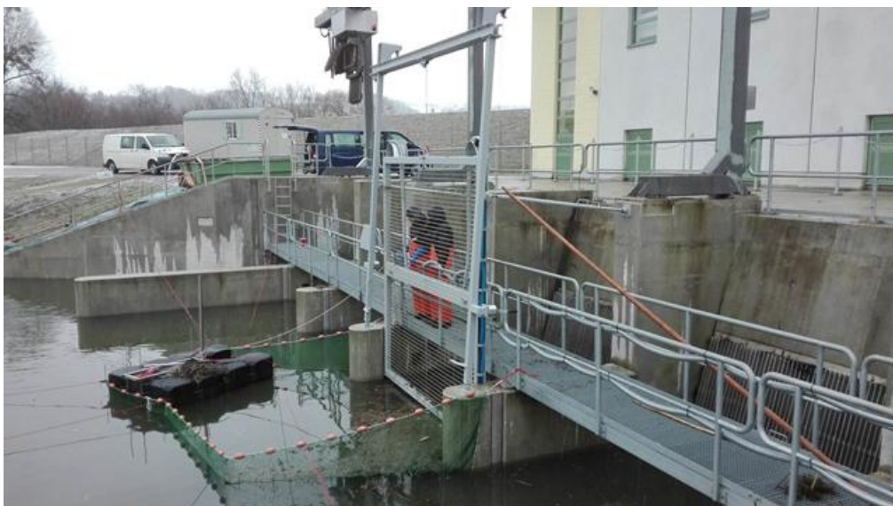
Abbildung 10: Elektro-Seilrechen am Pumpwerk Saubach/Deggendorf, bestehend aus zwei Feldern und Schwimmponton an dem das Multibeam-Sonar ARIS befestigt wurde
