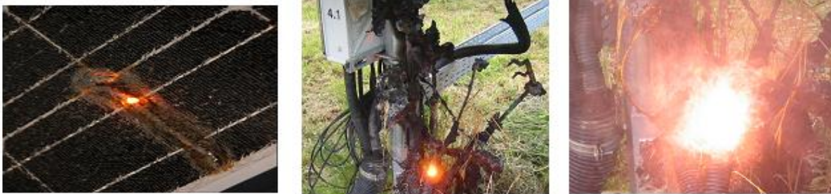
Abbildung 19: Beispiele zu real auftretenden Lichtbögen (links: Aufschmelzen einer schadhaften Kontaktstelle direkt im PV Modul, mitte und rechts: Brand am Stranganschlußkasten)
