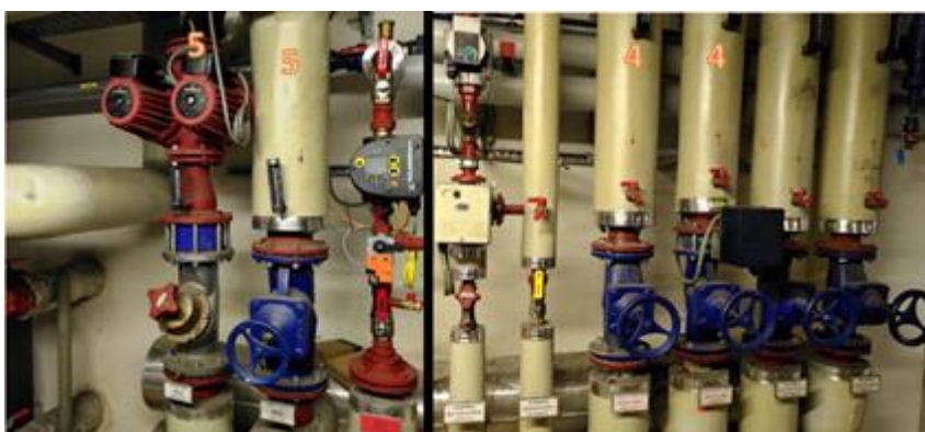
Figure 37: "Pumpenleitung WRG Vorlauf" (left) and "Verbindungsleitung Kessel-WRG Rücklauf" (right) in the basement
