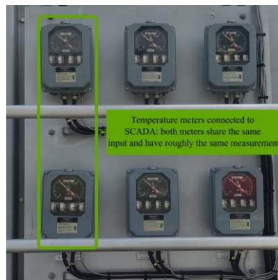
Abbildung 46: An das SCADA angeschlossene Zähler: Beide Zähler messen immer ungefähr den gleichen Punkt.
