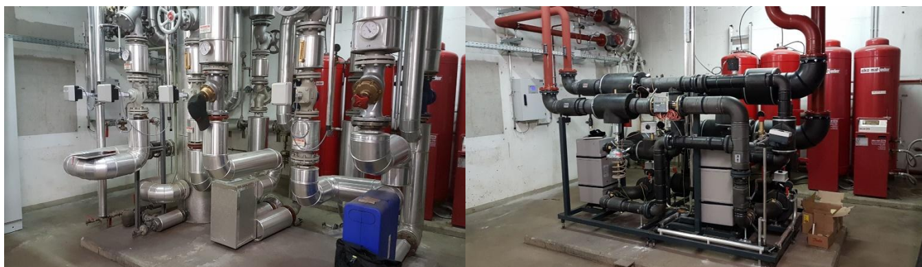
Abbildung 36: Optimierungsmaßnahme: Umbau der einer Kundenanlage mit 1 MW Anschlussleistung: Anlage vor (linke Abbildung) und nach (rechte Abbildung) Umbau
