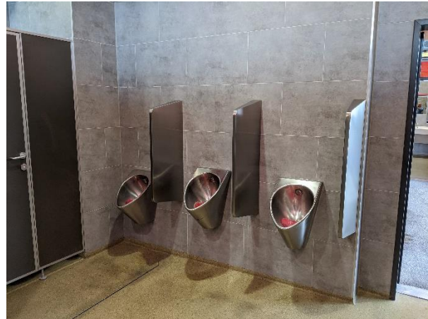
Abbildung 35: Wasserspül-Uriale in der Männertoilette. Für den Zeitraum der Probenentnahme würde die Wasserspülung deaktiviert um das Vorhandensein von Wasserlosen Urinalen zu simulieren.
