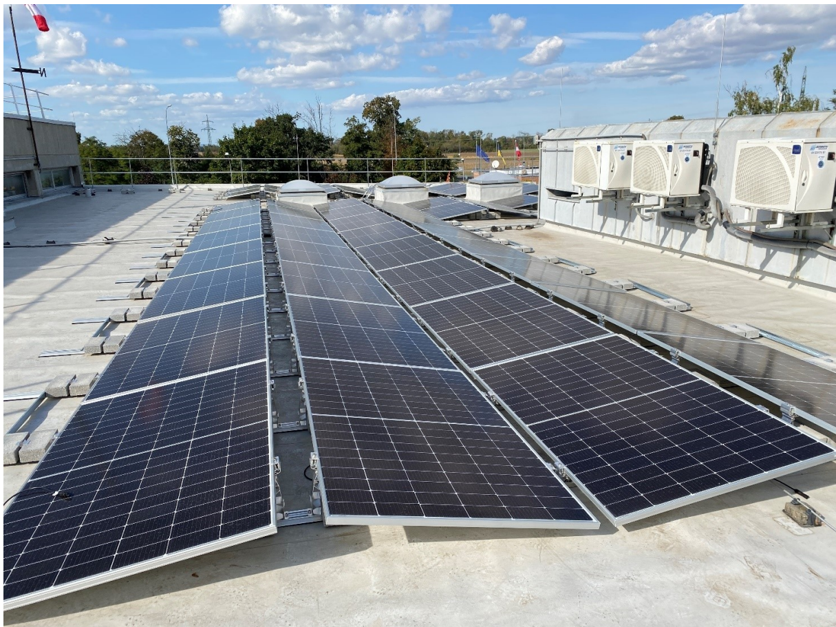
Abbildung 2: Ein Teil der dem H 2 -Demonstrator zugeordneten Abschnitt der PV-Anlage (63 kW p ). Ausrichtung der n-Typ-Module ist Südost und Nordwest.
