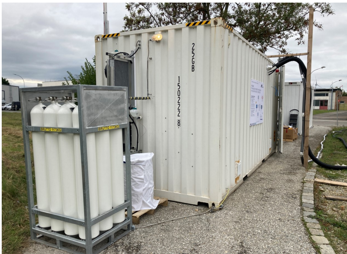
Abbildung 5: Rückansicht des H 2 -Demonstrators mit Gasspeicher und Rückkühler. An der Containerseite ist eine Infotafel zum Projekt angebracht.
