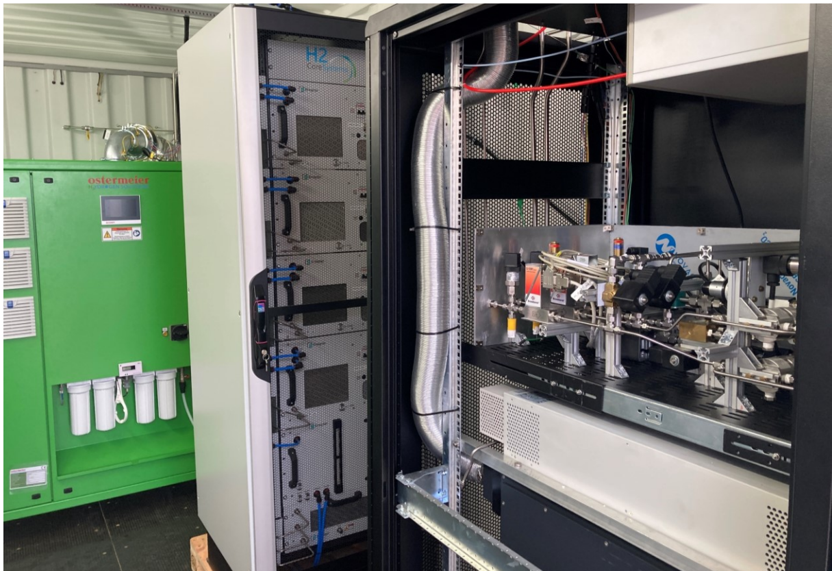
Abbildung 4: Links PEM-Elektrolyseur, Mitte AEM-Elektrolyseur, rechts Schaltschrank mit Mess- und Steuerungstechnik, Brennstoffzelle und Gasanalyse.
