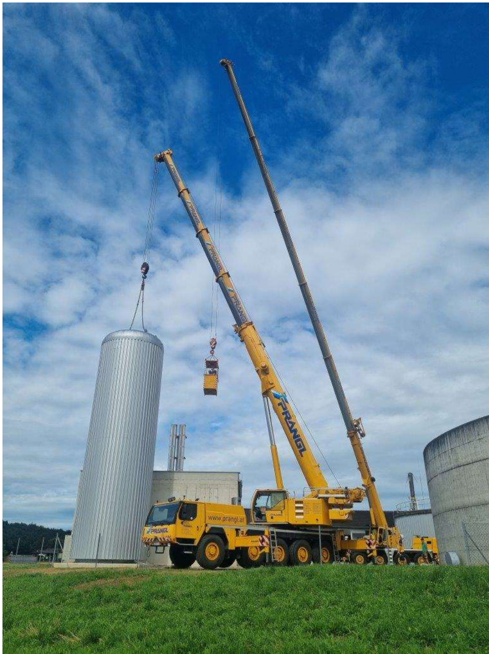
Foto: Aufstellung Speicher
